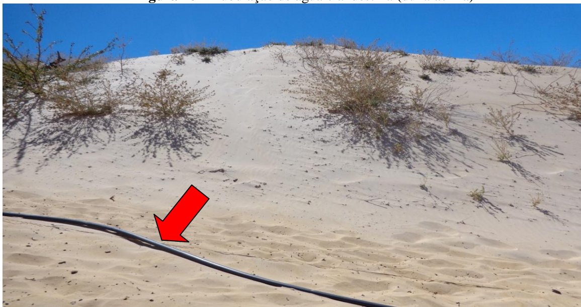
Figura 76 – Tubulação de água clandestina (duna acima)
