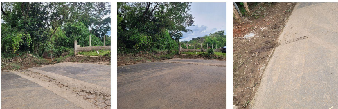
Figura 11 - Estado atual (2023) do final da Rua Vidal Barbosa, em Inconfidentes, próxima às margens do Rio Moji-Guaçu.
